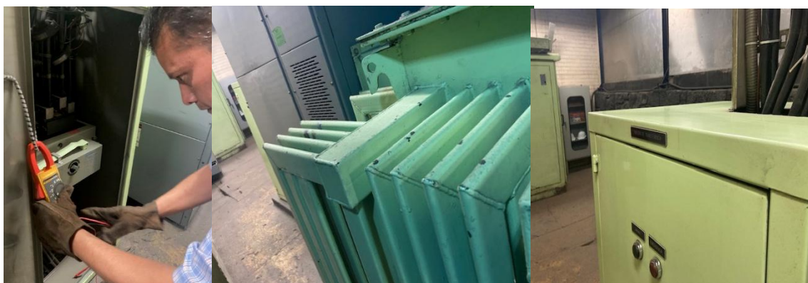
Figuras 47, 48 y 49. Calibración de equipos dentro de la subestación eléctrica
