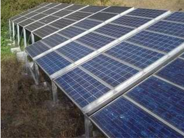
Batería de paneles solares.
